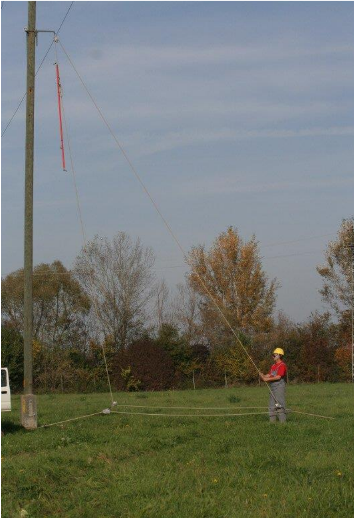
Exemplu de utilizare a funie de ajutor pentru urcarea manuală pe stâlp a unei prăjini electroizolante
