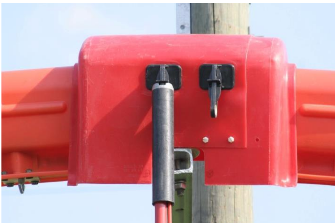
Exemplu de utilizare a unui protector rigid electroizolant pentru acoperirea unui izolator suport.
