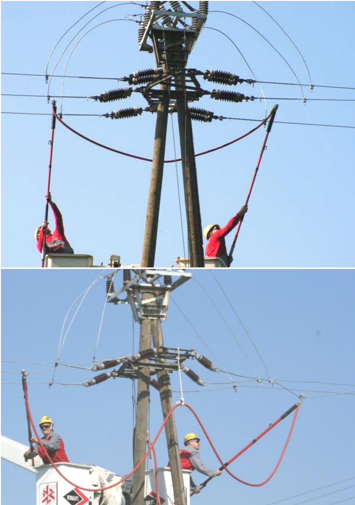
Exemple de utilizare a unui șunt pentru asigurarea continuității galvanice în vederea intervenției la un separator.
