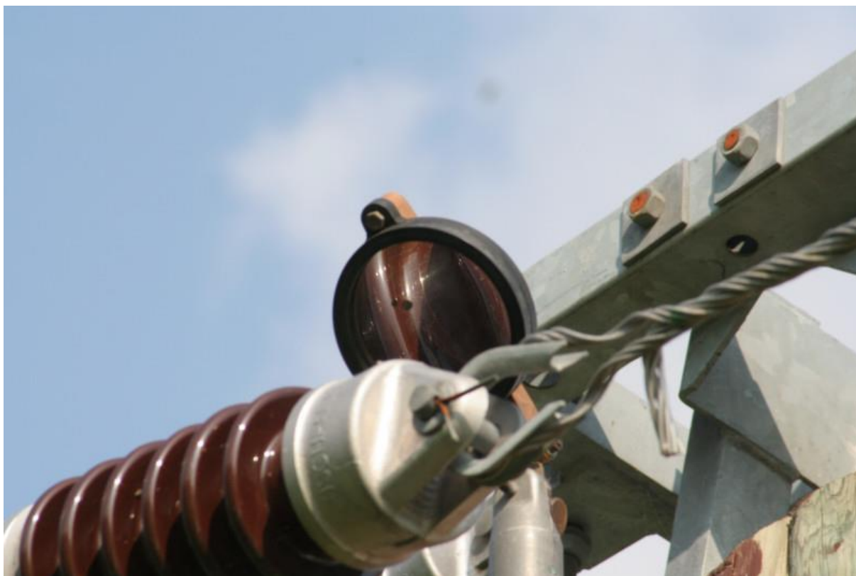
Exempu de utilizare a unei oglinzii pentru inspectarea părții invizibile a unui izolator de întindere
