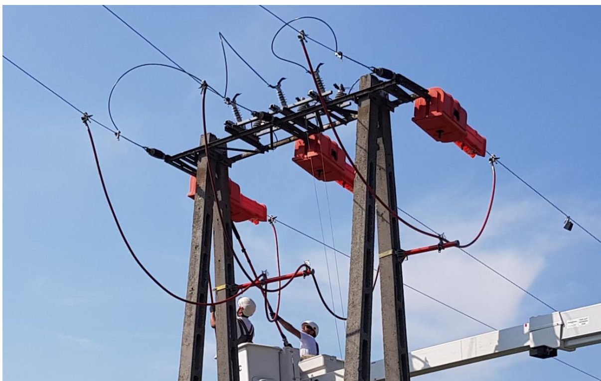
Exemple de utilizare a unor suporturi pentru conductor la susținerea unor șunturi.
